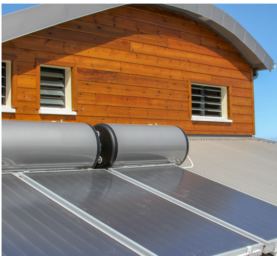
Instalación para el particular en sistema de termosifón acoplado.
